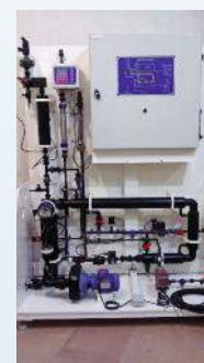
Générateur de bioxyde de chlore
